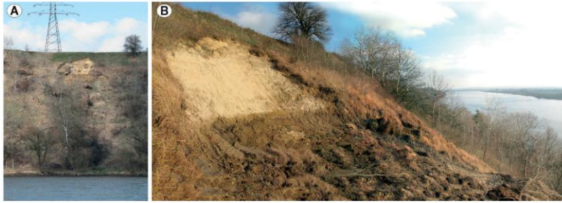
Ryc. 7. Przykład osuwiska na skraju Wysoczyzny Świeckiej z rejonu Morska (A – widok ogólny, B – skarpa główna) (za: Tyszkowski 2014, ryc. 4)
